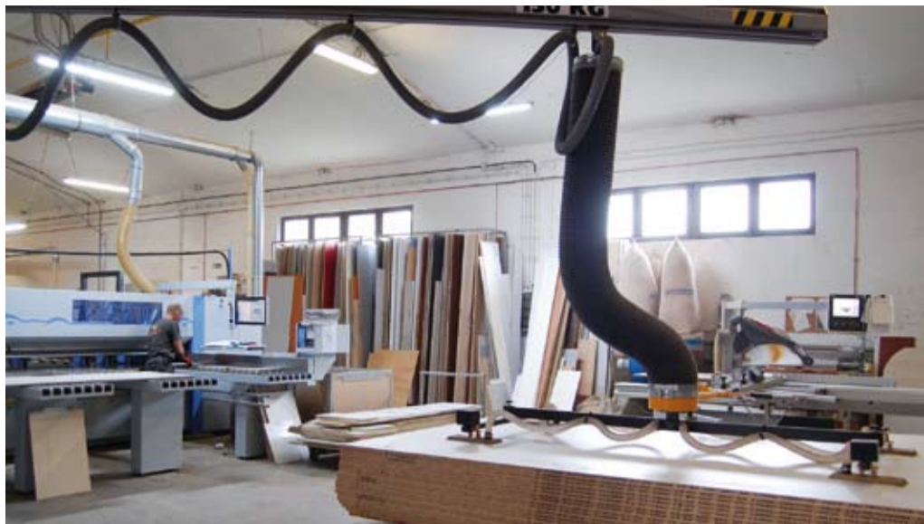
Manipulator zainstalowany jest na żurawiu z 5-metrowym ramieniem.
